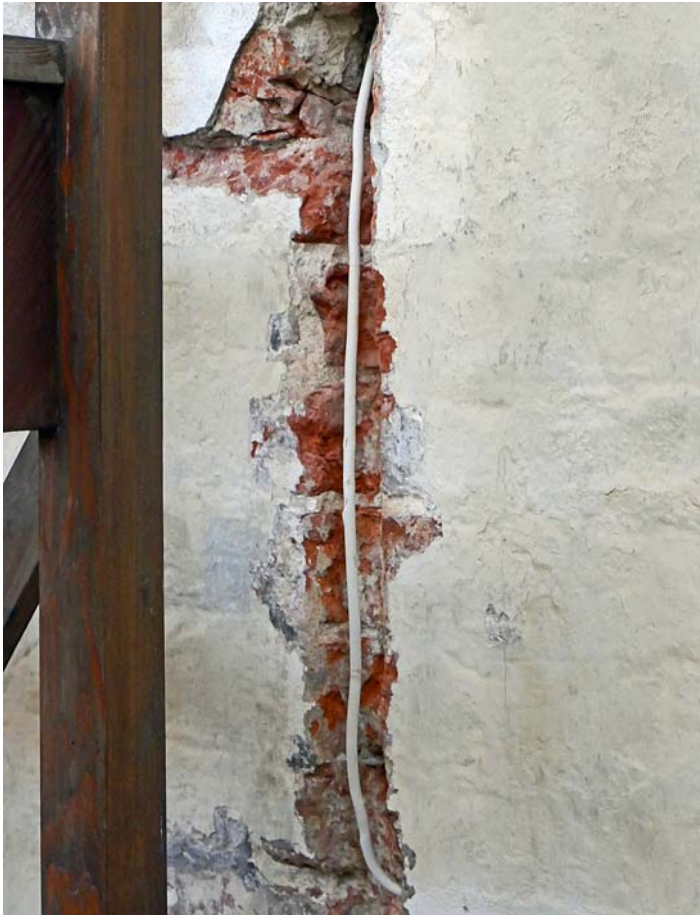
Oben: Kein Umkleide-Vorhang bei Kik, sondern das Entrée der bedeutendsten Franziskanerkirche im Norden. Darunter: Ein ordentlicher Boschhammer schafft auch gotisches Mauerwerk (nördliches Seitenschiff)
