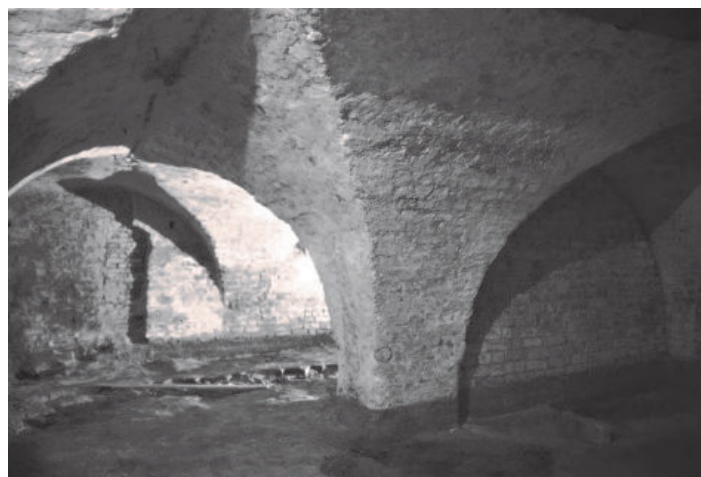
Ein Keller mit Kreuzgratwölbung, hier Mengstraße 40 (nach Mitte 13.J.). – dem Keller Mengstraße 6 in Form und (einstiger) Funktion sehr verwandt.
