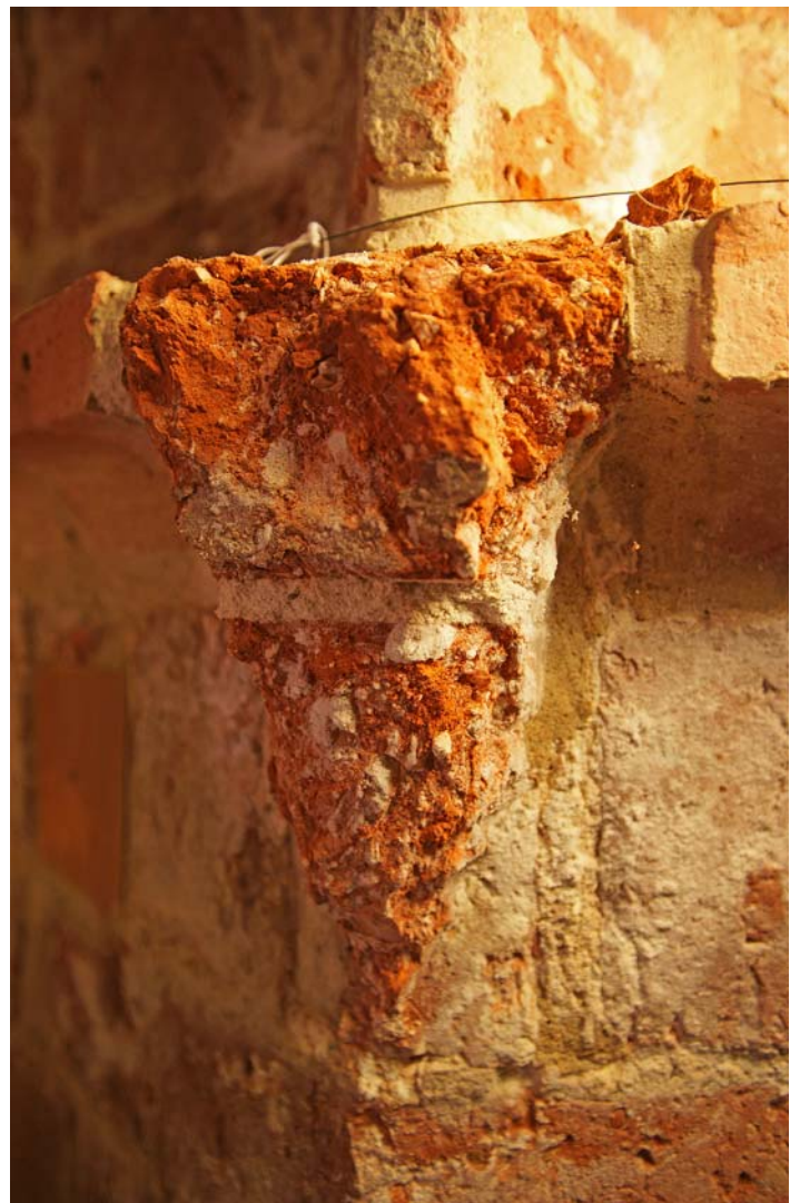
Oben: Im Ochsenkeller. Eine der völlig zerstörten Gewölbekonsolen.
